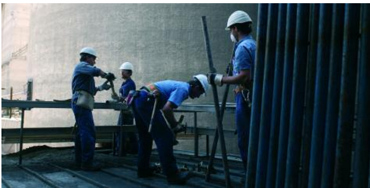
Robilante, Italia: manutenzione straordinaria dei silos cemento Robilante, Italy: maintenance works to cement silos
