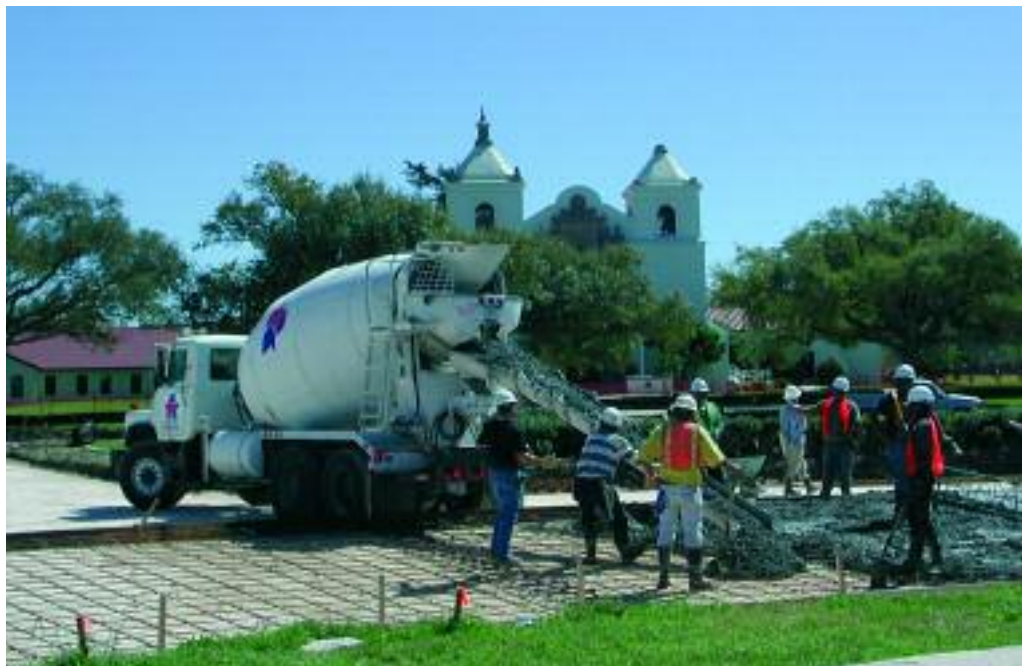
Getto di calcestruzzo Alamo Concrete alla base aerea militare Randolph, presso San Antonio, TX Pouring Alamo concrete at Randolph air Force Base in San Antonio, TX
